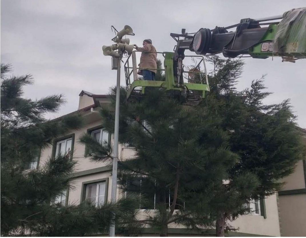
Bakıma ihtiya duyulan anons sistemindeki hoparlörlerin kontrolleri yapıldı.
